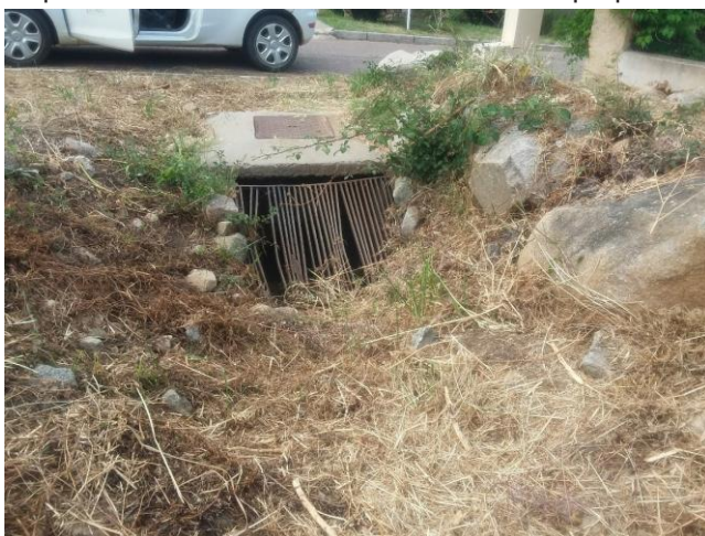
Obstruction fréquente de la grille
