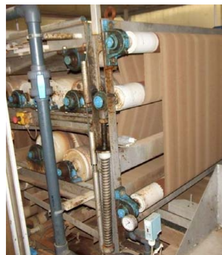
Presse à bandes (déshydratation des boues)
