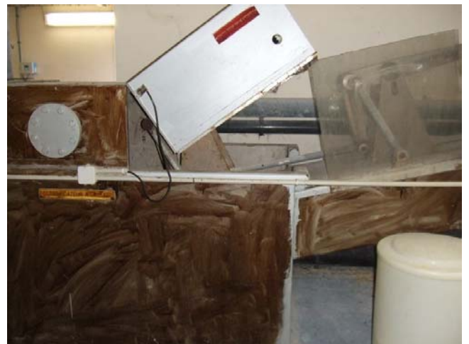
Traitement des sables
