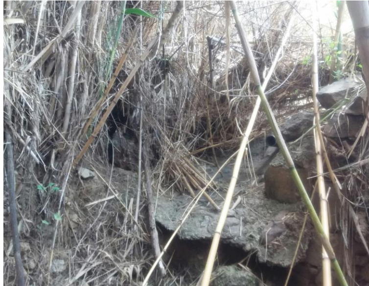
Cannes et affouillement sous radier béton
