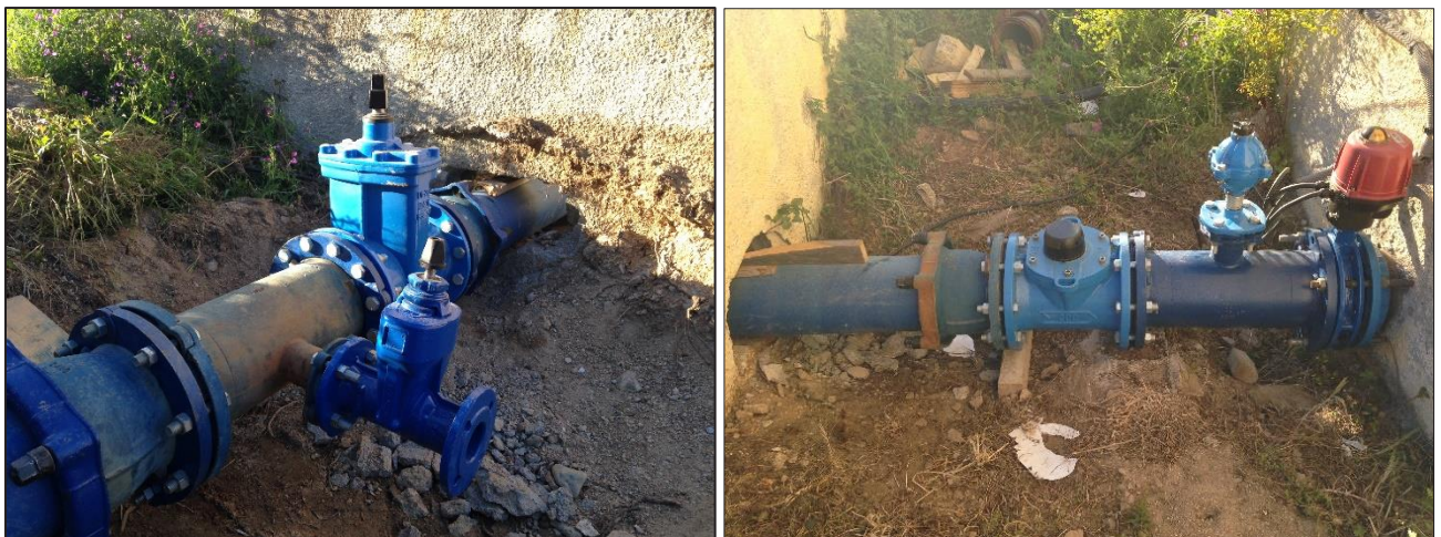
Figure 43 : Arrivée forages et puits station CORMORAN
