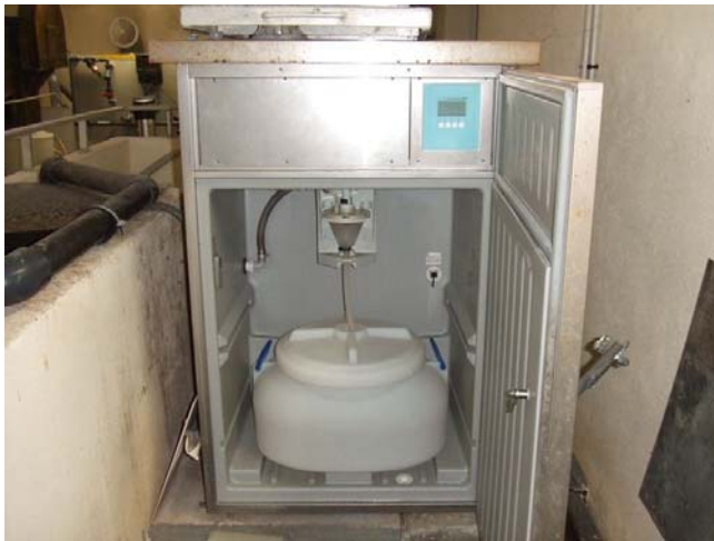
Préleveur entrée station
