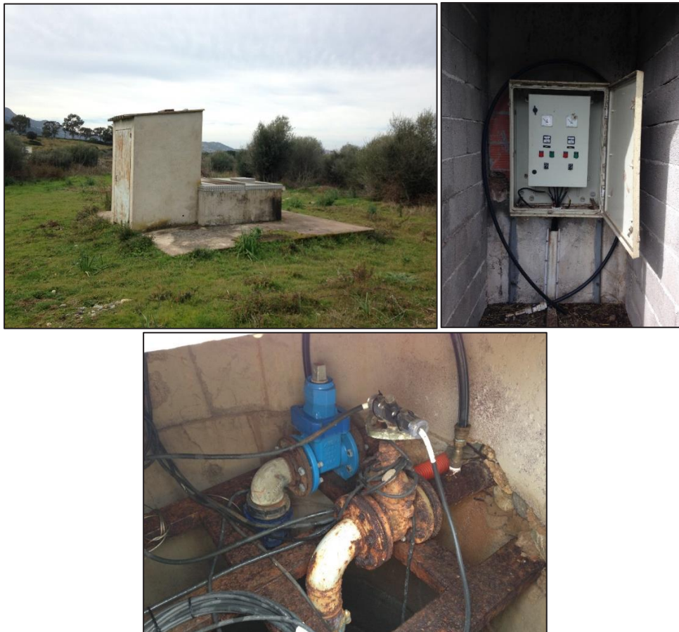
Figure 18 :Puits Beveraggi 1 et armoire de commande
