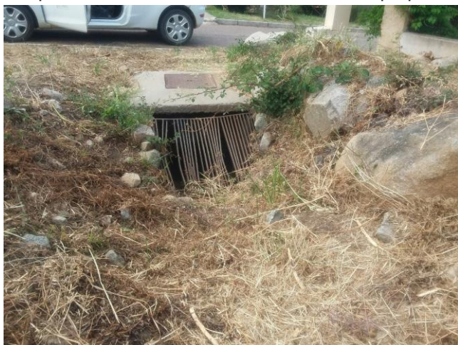
Obstruction fréquente de la grille
