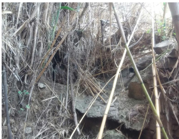
Cannes et affouillement sous radier béton
