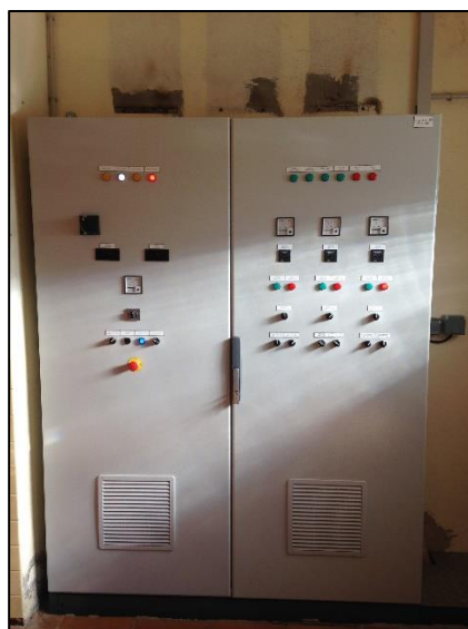
Figure 38 :Armoires de commande des 3 pompes
