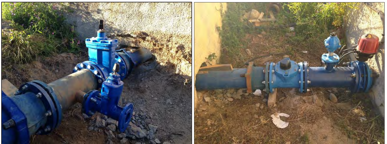
Figure 43 : Arrivée forages et puits station CORMORAN
