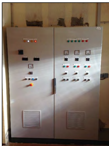
Figure 38 :Armoires de commande des 3 pompes
