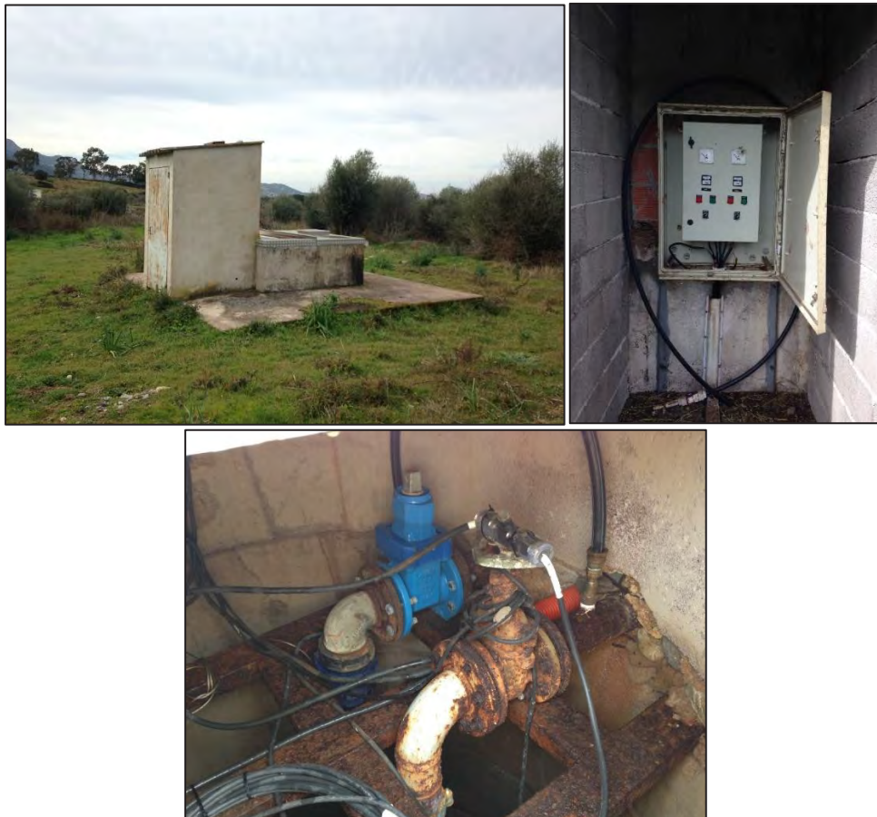
Figure 18 :Puits Beveraggi 1 et armoire de commande
