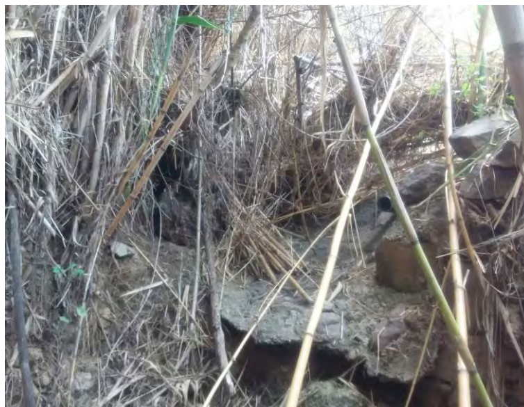
Cannes et affouillement sous radier béton
