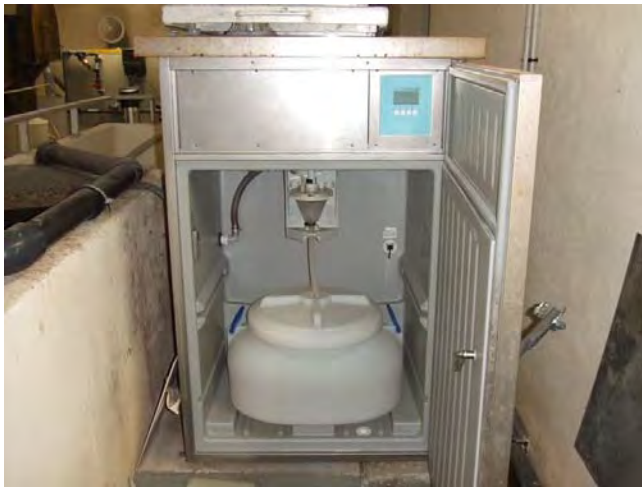
Préleveur entrée station
