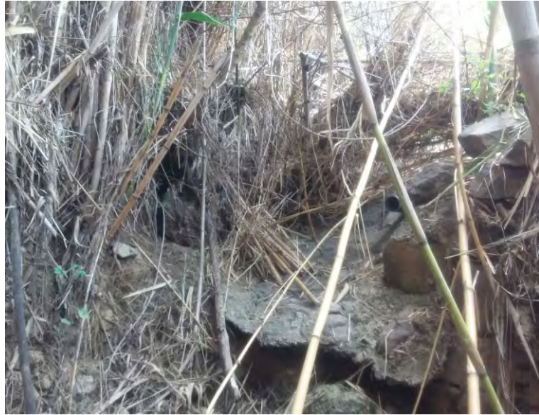
Cannes et affouillement sous radier béton
