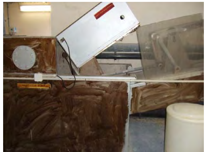
Traitement des sables
