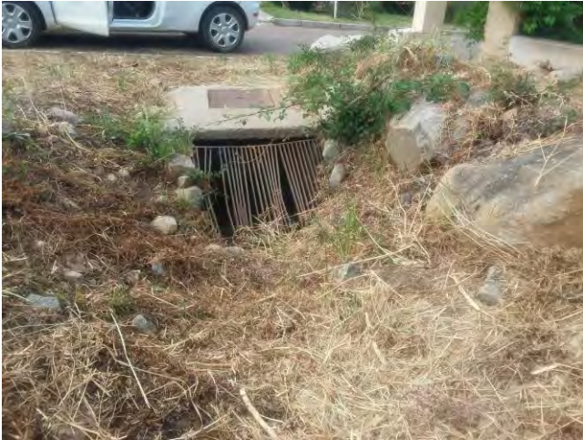
Obstruction fréquente de la grille
