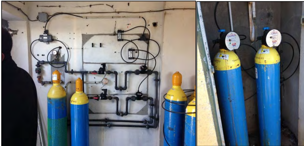
Figure 39 :Local de chloration et cabine
